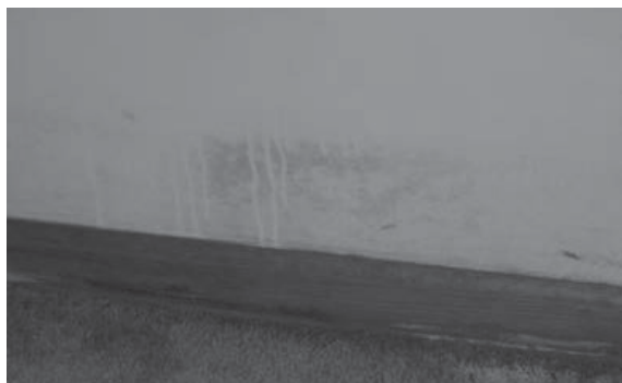
Mold on drywall
