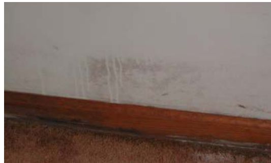
Mold on drywall
